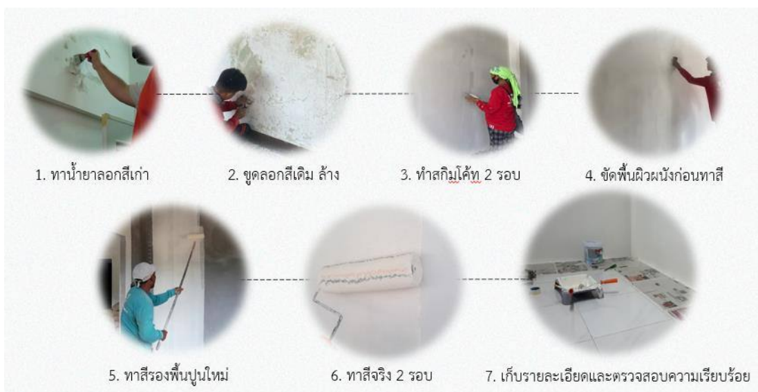
ภาพที่ 4.4 ขั้นตอนการดำเนินงานกรณีผนังเดิมเป็นผนังฉาบปูนทาสี ทำการปรับปรุงสภาพโดยการขูดสีเดิมออกและทาสีใหม่
